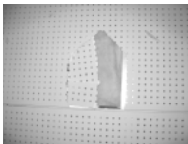
1022教室の壁の傷
