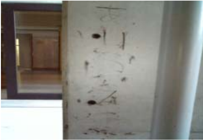
写真3 . 6号館と8号館の間の階段の壁
