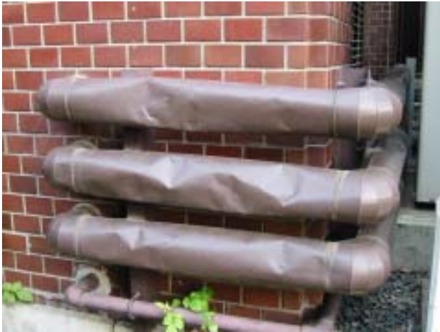
写真1 . 10号館東入口付近の配水管
