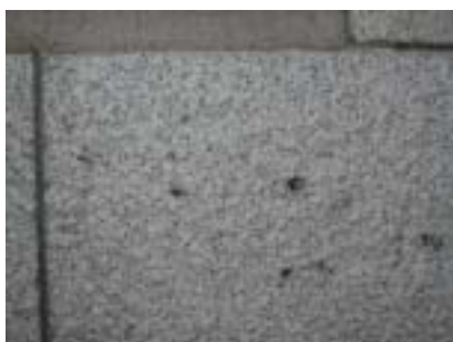
写真1 . 3号館入り口の壁
